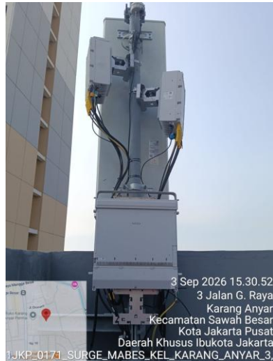
Rooftop pole Sawah Besar · Central Jakarta
